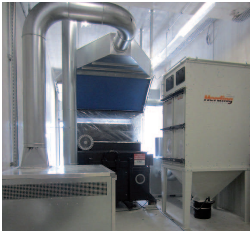
Het Herding Filter met stofemmer (rechts), met op de voorgrond (links) de transportventilator met het leidingwerk naar de separator (blauw). Op de achtergrond de perscontainer (zwart) die met een flexibel materiaal aan de separator is verbonden. Rechts achter bevindt zich de ventilator van het Herding Filter
